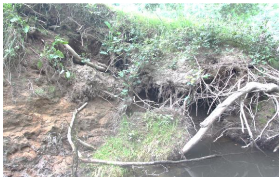
Photo 9 : effondrement de berge sur la Boulogne © Polleniz
