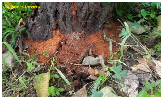
Sciure de forage au pied d'un arbre
